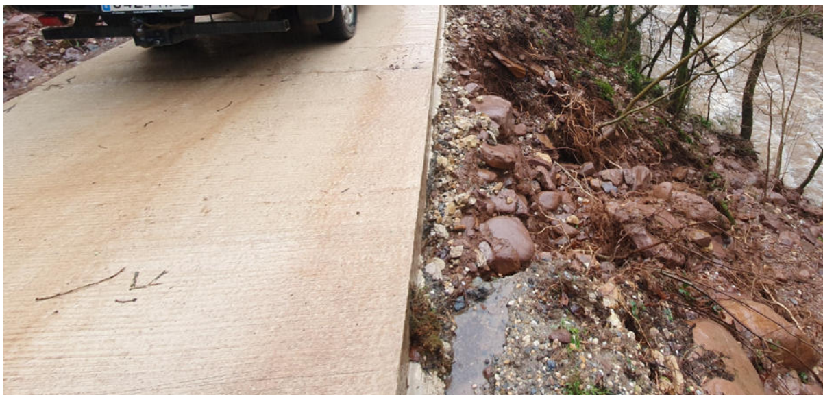
Fotografía2 del terraplén derrumbado en el camino
