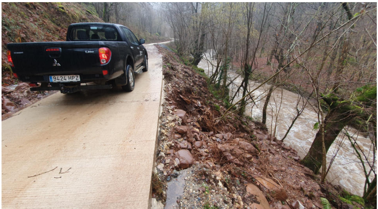
Fotografía1 del terraplén derrumbado en el camino
