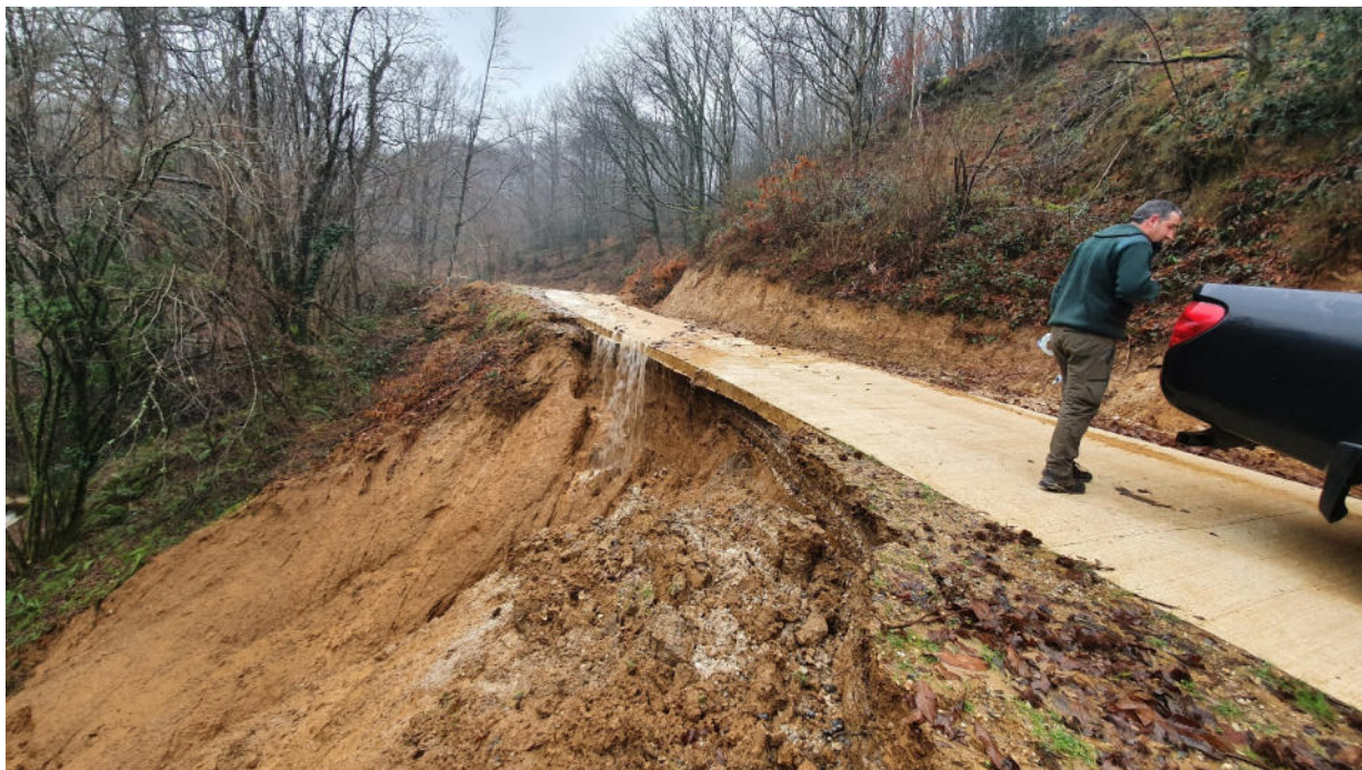
Fotografía2 del terraplén derrumbado en el camino
