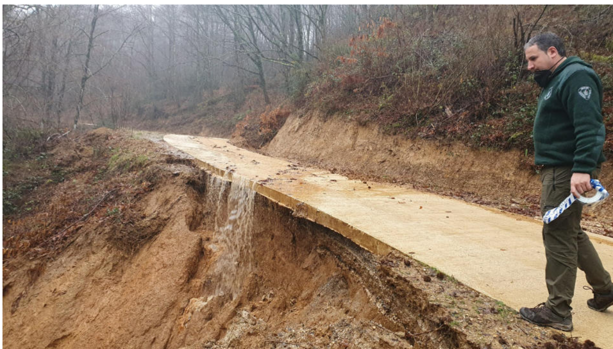
Fotografía1 del terraplén derrumbado en el camino
