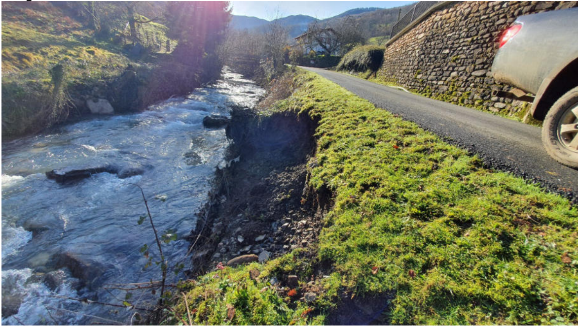
Fotografía1 del terraplén derrumbado en el camino
