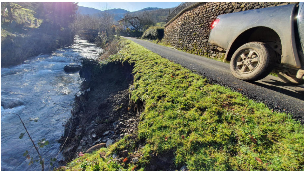
Fotografía2 del terraplén derrumbado en el camino
