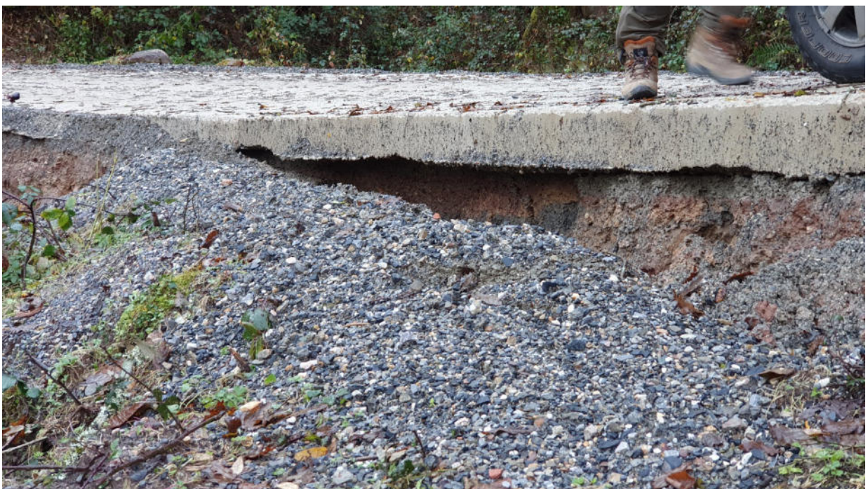
Fotografía2 del terraplén derrumbado en el camino
