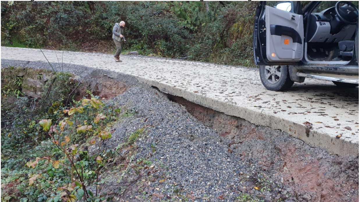
Fotografía1 del terraplén derrumbado en el camino
