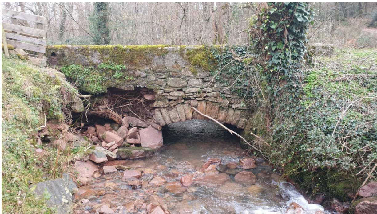
Fotografía de los daños aguas arriba del puente
