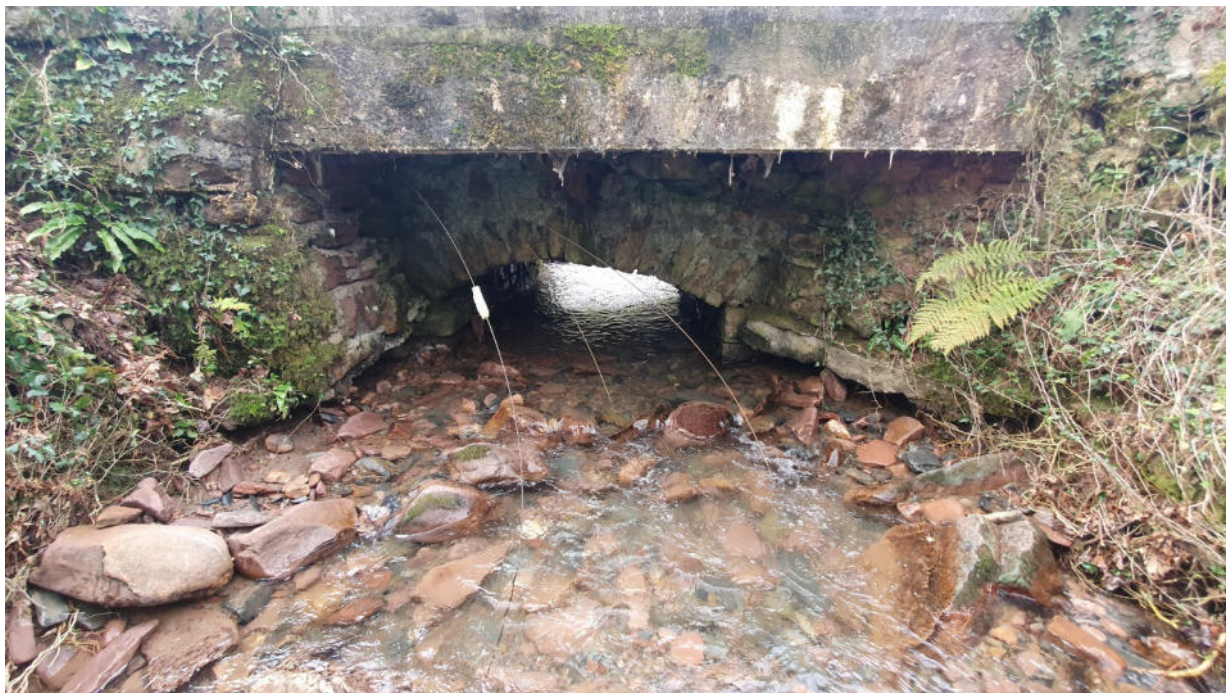
Fotografía de los daños aguas abajo del puente
