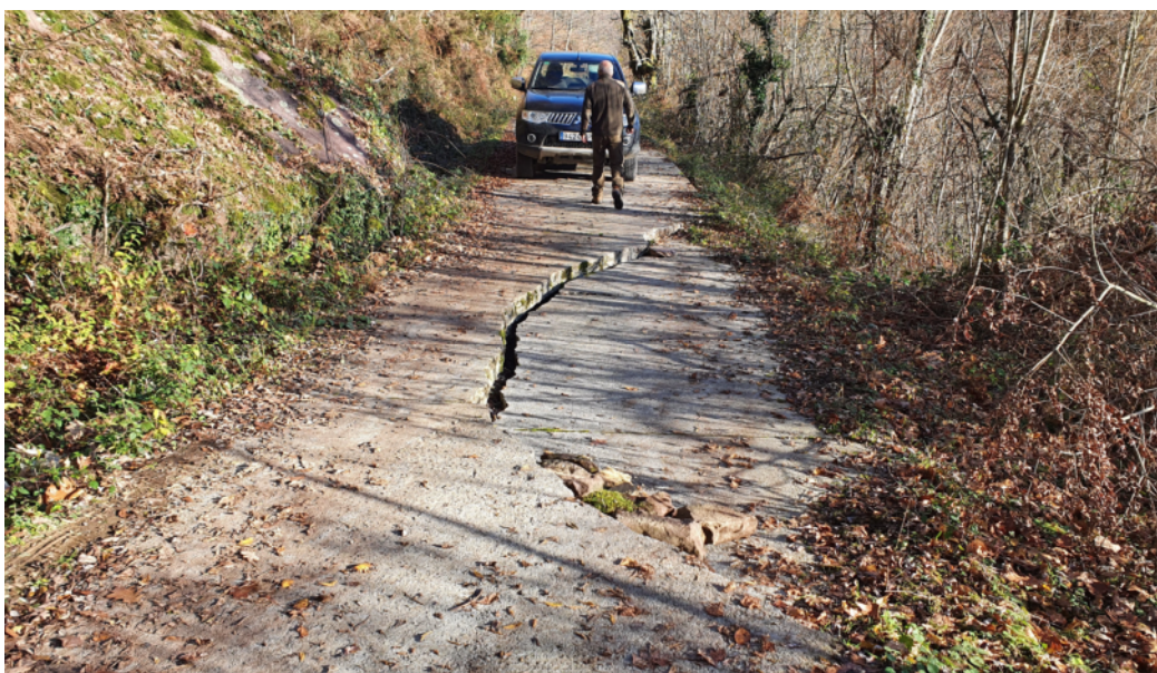
Fotografía1 del terraplén derrumbado en el camino a Legaleta Borda
