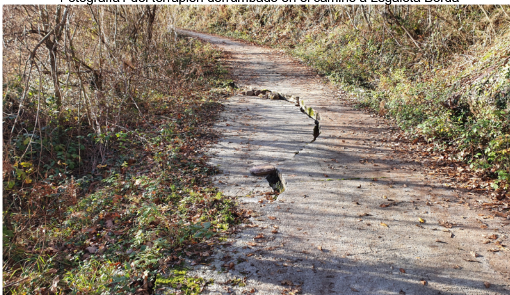
Fotografía2 del terraplén derrumbado en el camino a Legaleta Borda
