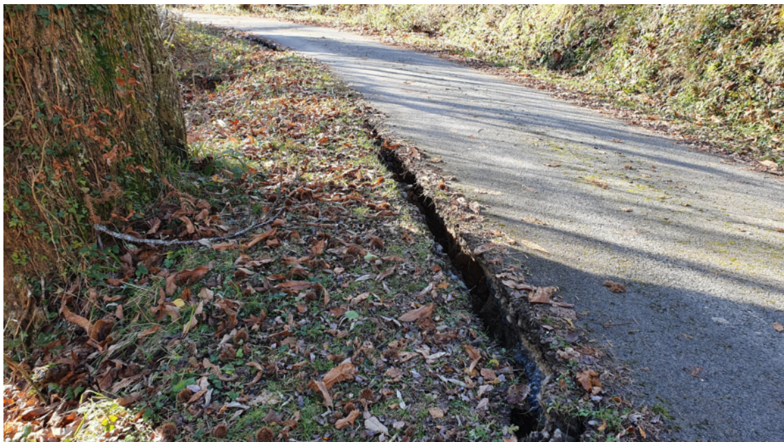
Fotografía3 del terraplén derrumbado en el camino a Legaleta general
