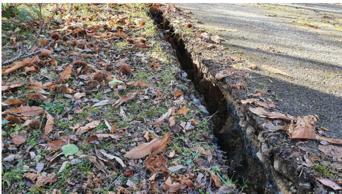
Fotografía4 del terraplén derrumbado en el camino a Legaleta general
