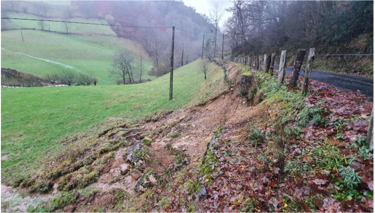
Fotografía3 del terraplén derrumbado en el camino
