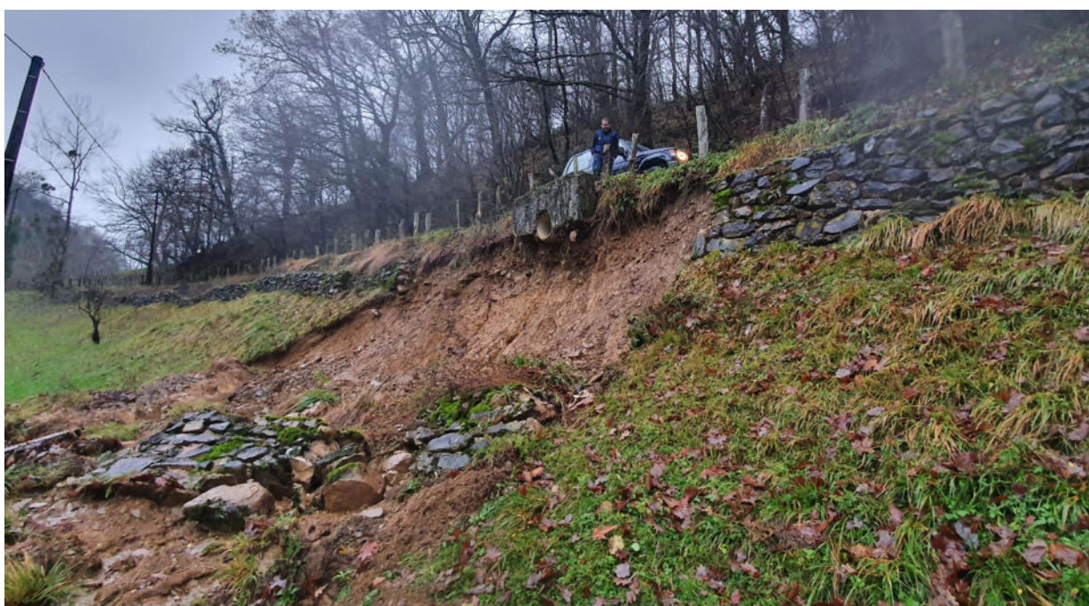
Fotografía2 del terraplén derrumbado en el camino
