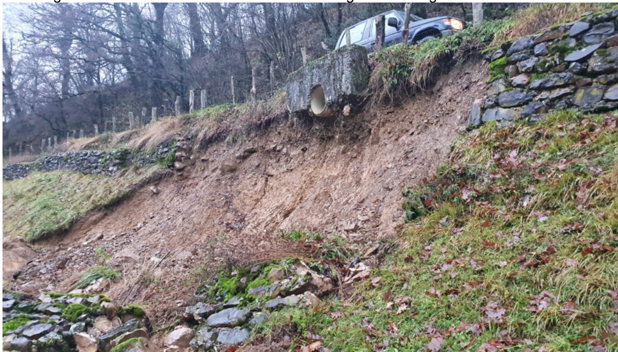
Fotografía1 del terraplén derrumbado en el camino
