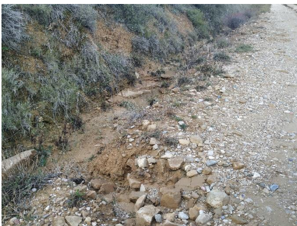
CAMINO 14 – Erosión con formación de cárcava que ha mordido parte de la anchura.
