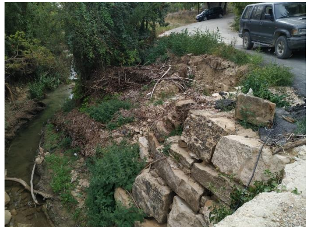
CAMINO 26 – Escollera de protección afectada. Desprendimientos.
