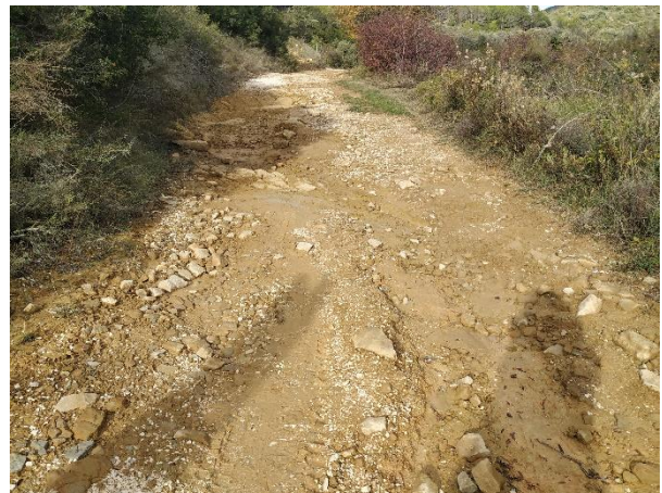
CAMINO 29 – Superficie irregular, pérdida de finos en superficie por erosión.
