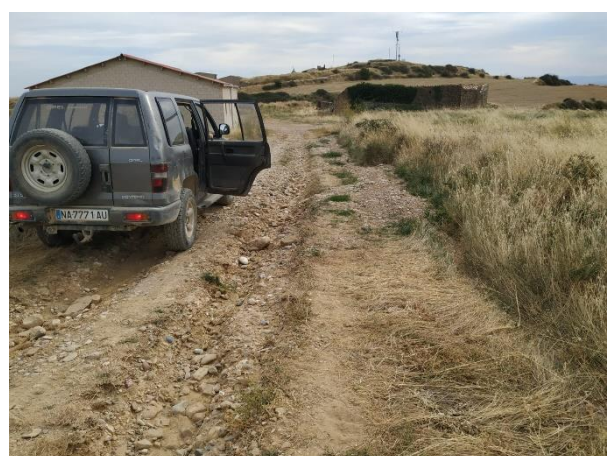
CAMINO 34 – Rodadas profundas en toda la longitud, circulación impracticable.
