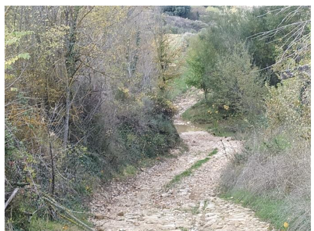
CAMINO 11 – Superficie muy erosionada con acumulación de agua en punto bajo.
