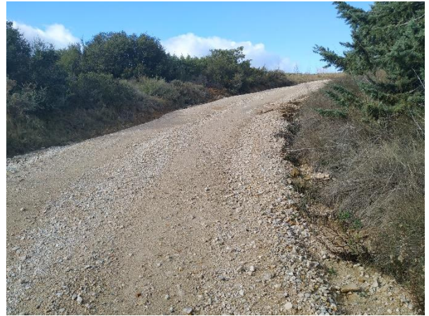
CAMINO 18 – Formación de cárcavas por erosión disminuyendo anchura del camino.
