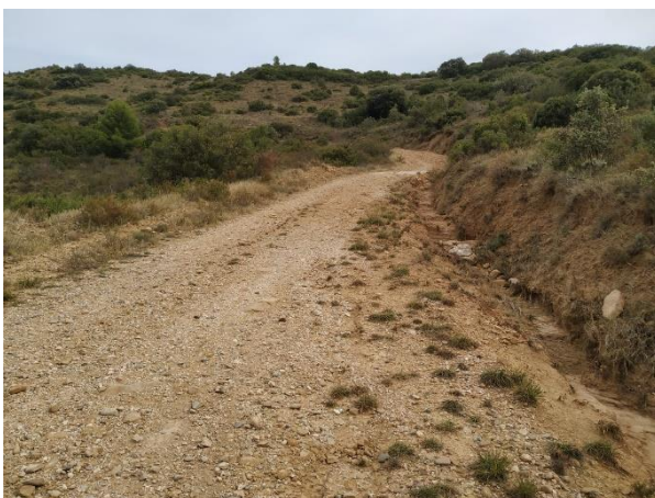
CAMINO 26 – Material suelto, superficie irregular y erosión en cuneta.
