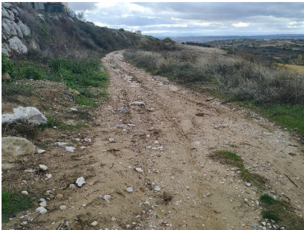
CAMINO 12 – Superficie irregular, materiales sueltos, baches y rodada.
