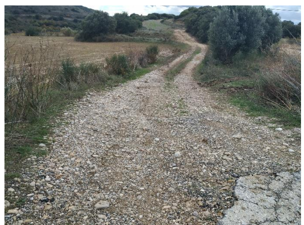
CAMINO 15 – Material suelto provocando superficie irregular.
