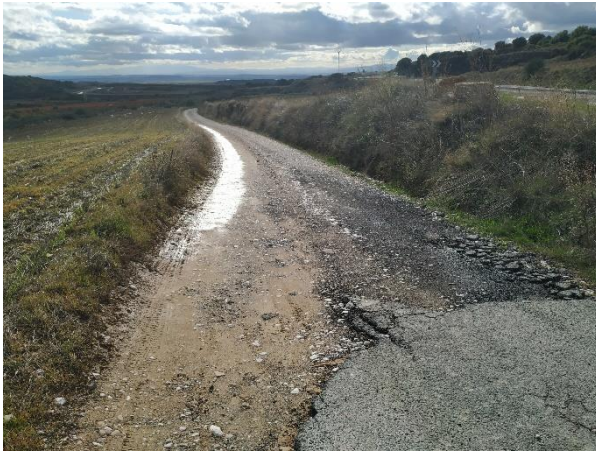
CAMINO 17 – Erosión en camino. Superficie irregular con materiales sueltos.
