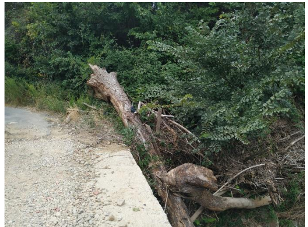
CAMINO 26 – Acumulación de vegetación arrastrada en el paso del agua.
