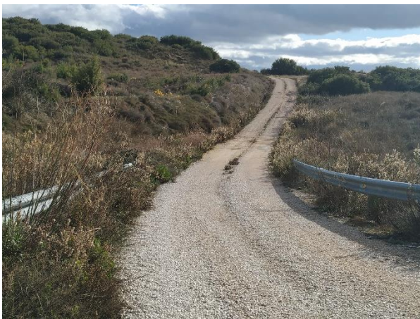
CAMINO 23 – Deterioros donde hay pendiente pronunciada, pérdida de finos.
