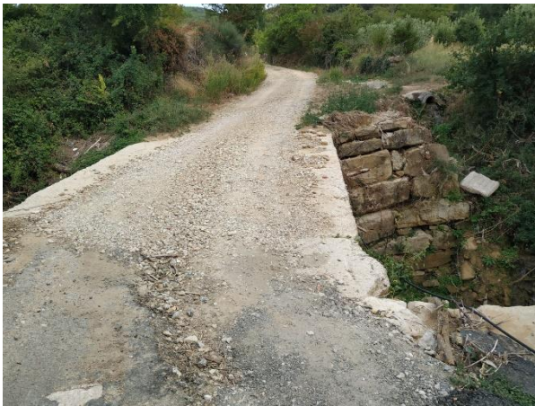
CAMINO 26 – Paso con estribos afectados por la fuerza del agua.
