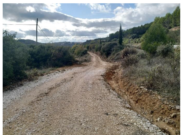
CAMINO 27 – Material suelto, superficie irregular y erosión en cuneta.
