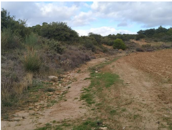
CAMINO 1 – Superficie erosionada con materiales sueltos de arrastre.
