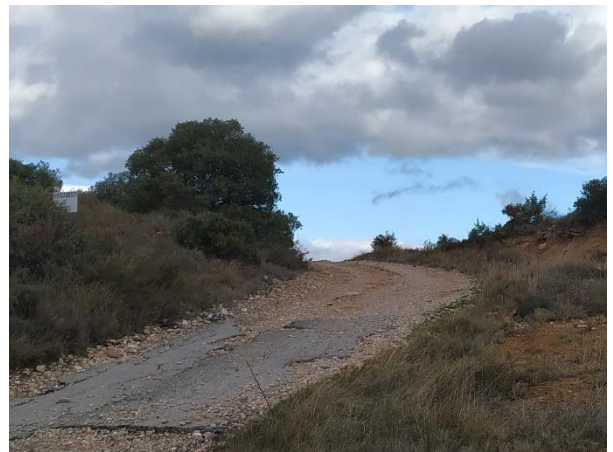
CAMINO 3 - Superficie erosionada con materiales sueltos de arrastre.
