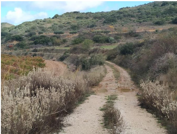
CAMINO 13 – Erosión que ha creado baches, hundimientos con acumulación de agua.
