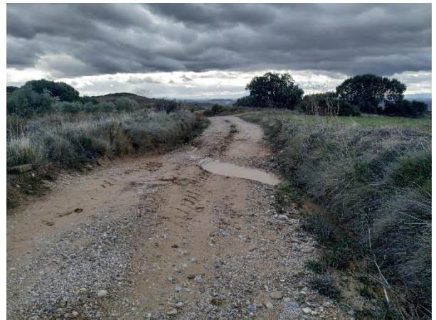
CAMINO 14 – Erosión, baches, acumulación material parte central, material suelto.
