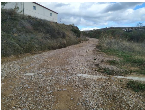
CAMINO 10 – Camino con gravas con material suelto en superficie.
