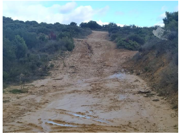
CAMINO 5 – Cárcavas en camino, material suelto, rodadas marcadas.
