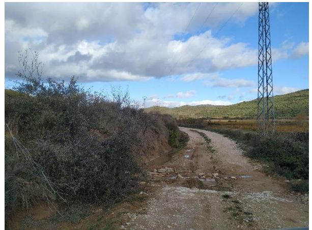
CAMINO 19 – Hundimiento con erosión. Materiales sueltos.
