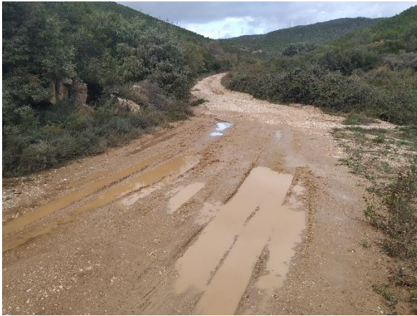
CAMINO 2 – Rodadas profundamente marcadas con acumulación de agua.
