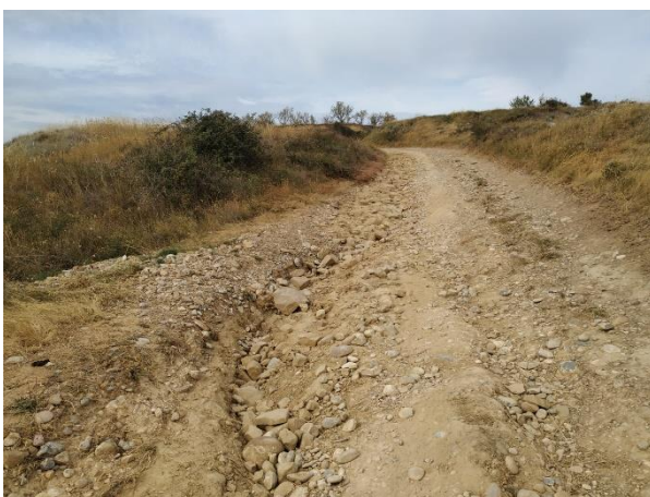
CAMINO 34 – Erosión, rodadas profundas, materiales grandes sueltos.
