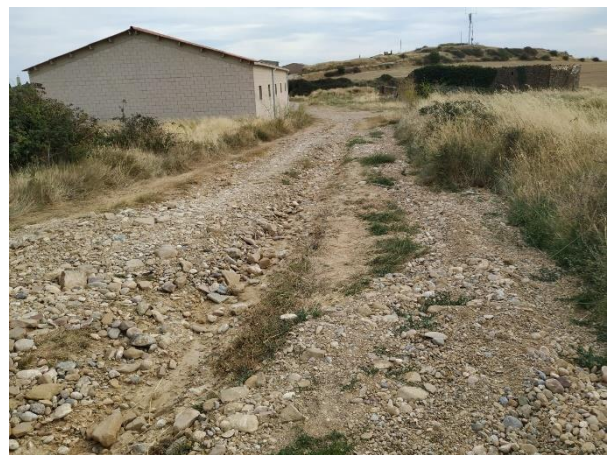
CAMINO 34 – Erosión, materiales sueltos, superficie irregular.
