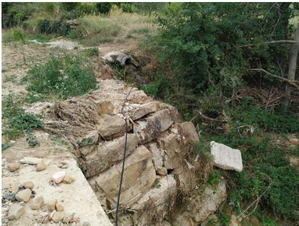
CAMINO 26 – Estribo deteriorado por la fuerza del agua de escorrentía.
