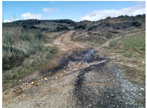
CAMINO 12 – Rodadas, superficie con acumulación de agua por irregularidades.
