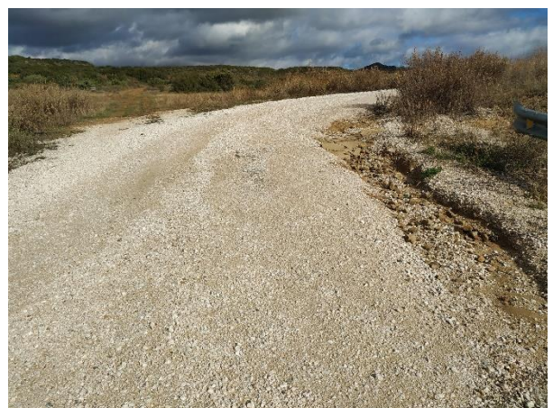
CAMINO 24 – Erosión en lateral de camino, pérdida de material por arrastre.
