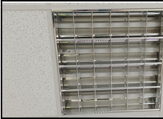
Luminaria fluorescente 4x18 W.
