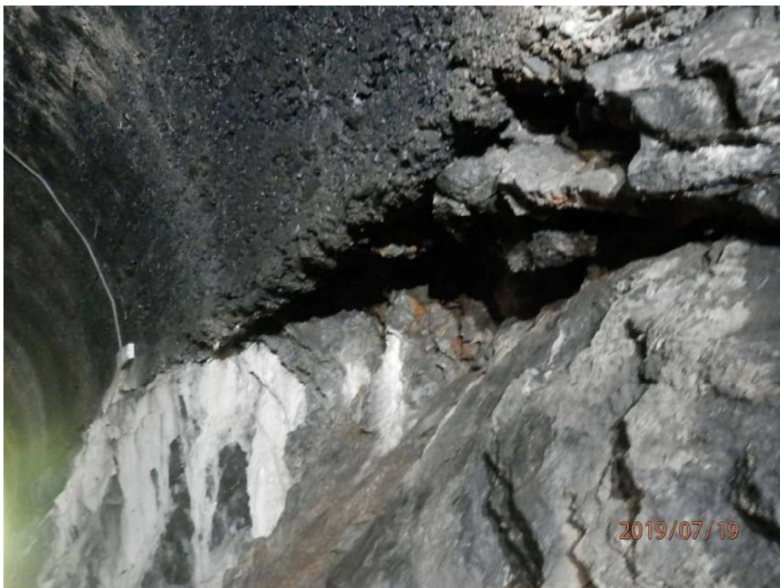
Imagen 1. Descalce de bóvedas en Túnel de Kantina
