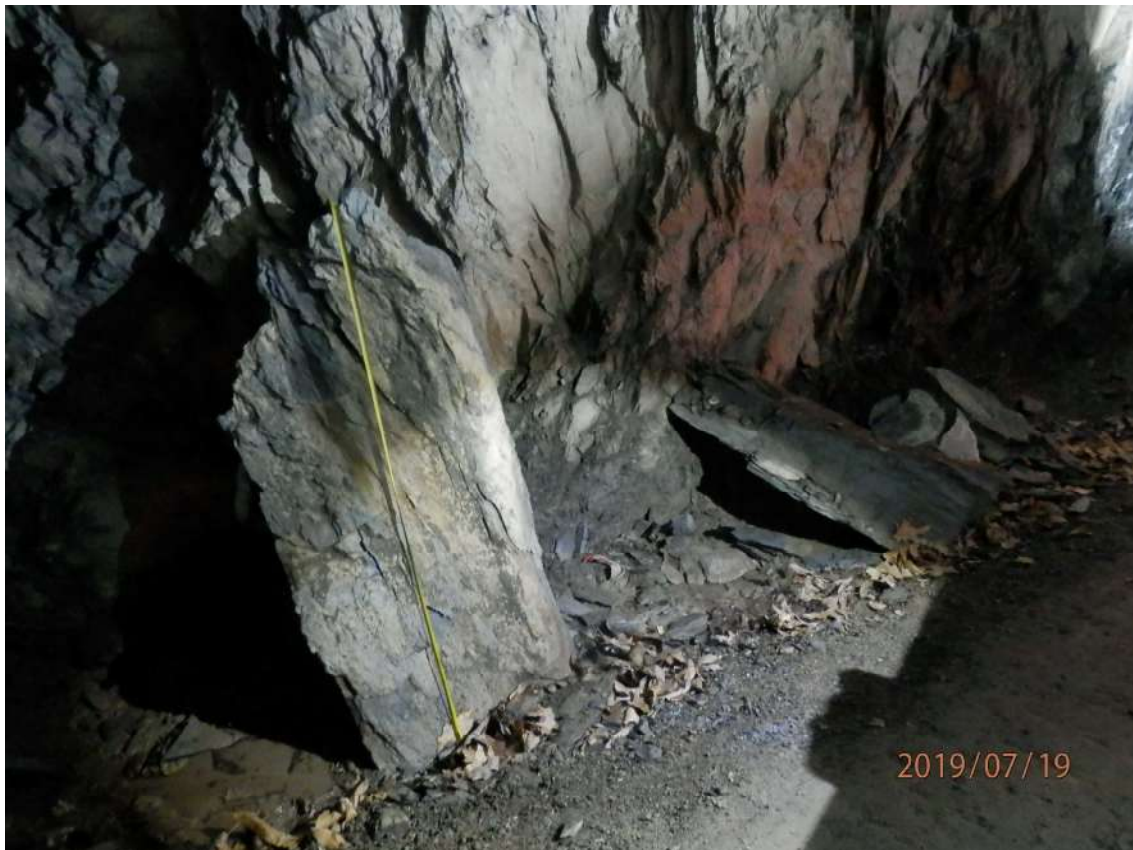
Imagen 2. Caída de bloques en el túnel de Kantina
