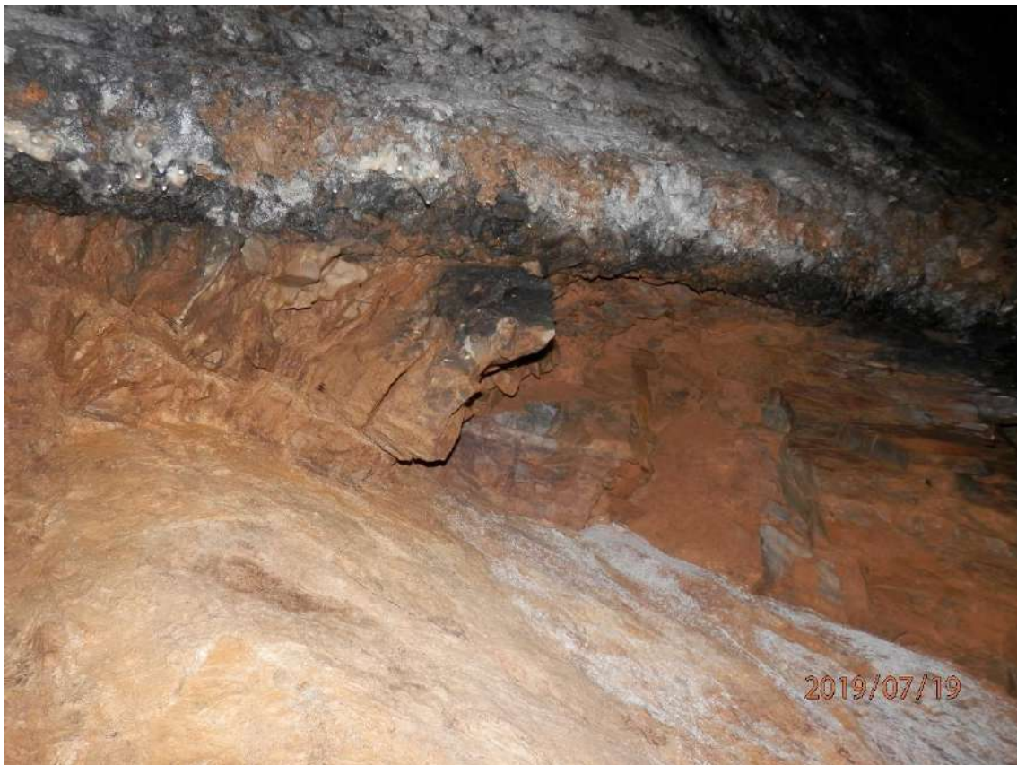
Fotografía 1. La roca se encuentra meteorizada y se ha perdido el apoyo de la bóveda
