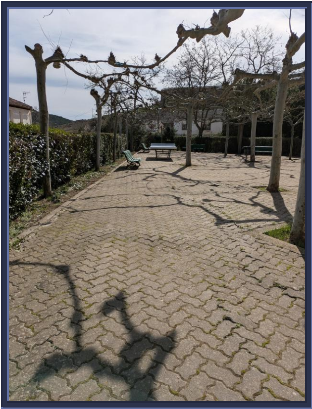
FOTOGRAFÍA 3: ESTADO INICIAL DEL MOBILIARIO URBANO DE LA PLAZA
