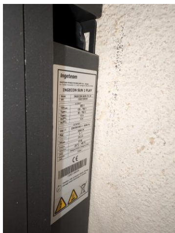
Fotografía 5: Ficha técnica del inversor de la instalación actual
