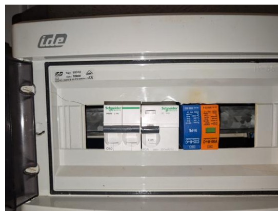
Fotografía 6: Cuadro de protecciones de la instalación actual
