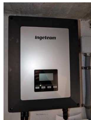
Fotografía 4: Inversor de la instalación actual
