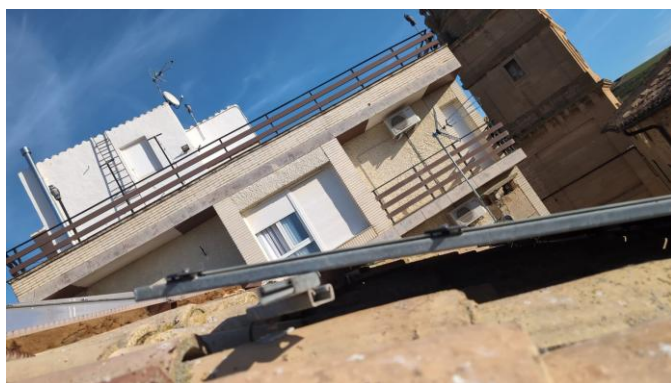
Fotografía 3: Estructura fotovoltaica actual
