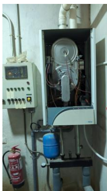
Fotografía 1: Caldera de gas existente
