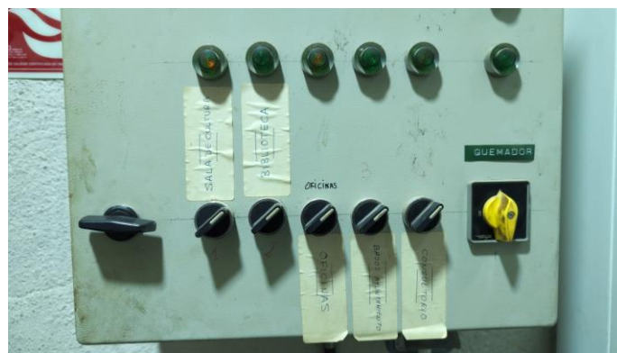
Fotografía 2: Botonera de control de circuitos de calefacción existente
