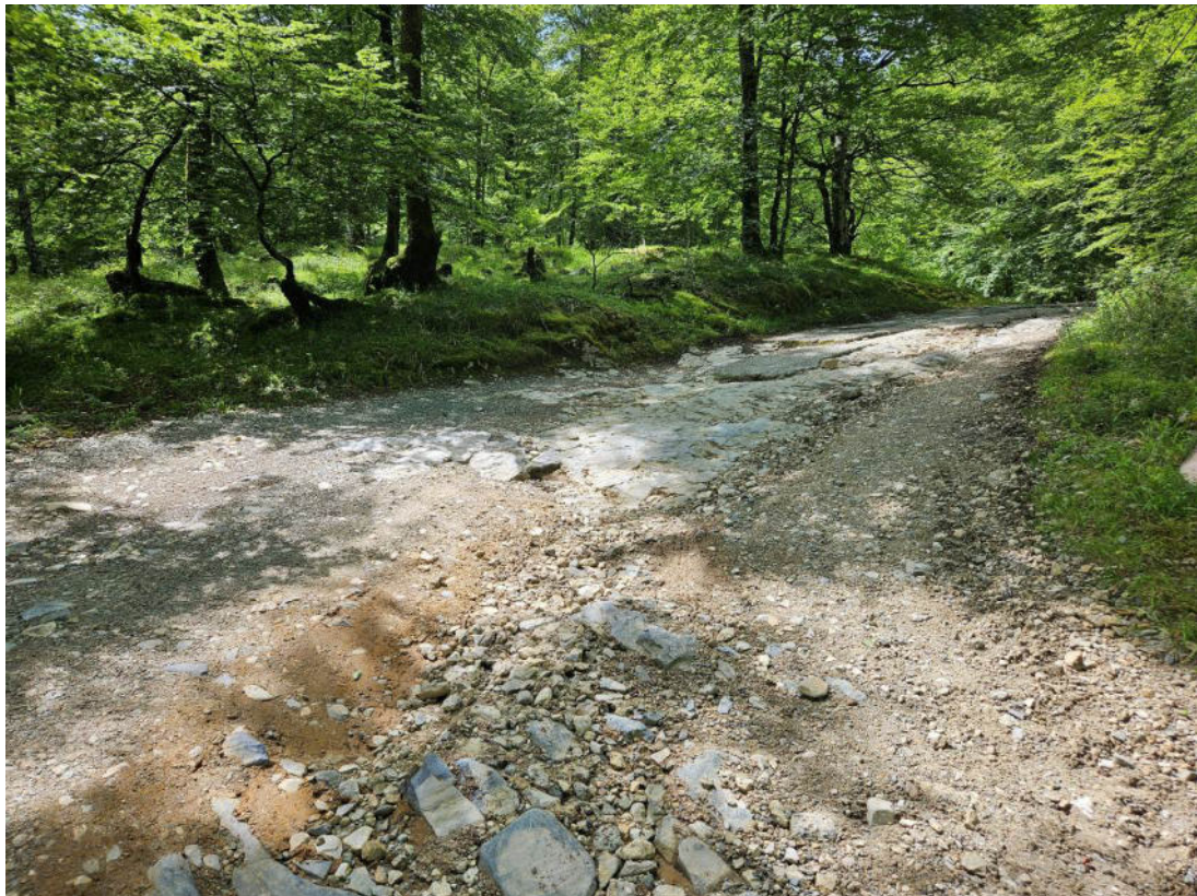
Otra fotografía donde se aprecia el mal estado de la explanación y el tramo a pavimentar con hormigón en Pista Ariztizelaia.
