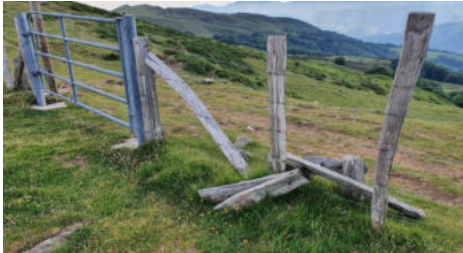
Estado actual de un paso elevado en el de Erdiz que precisa de reparación.
