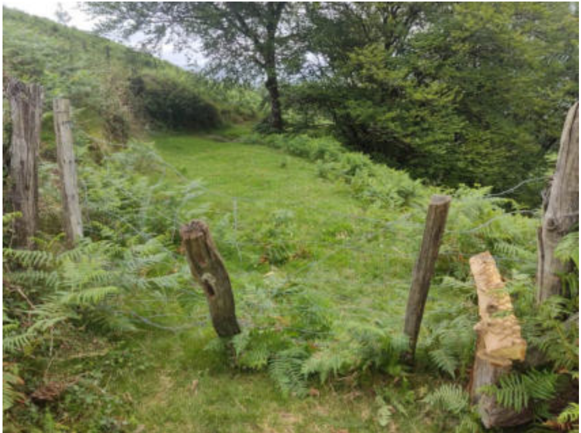
Estado actual de un paso elevado en el cierre de Lizartzu que precisa de reparación.
