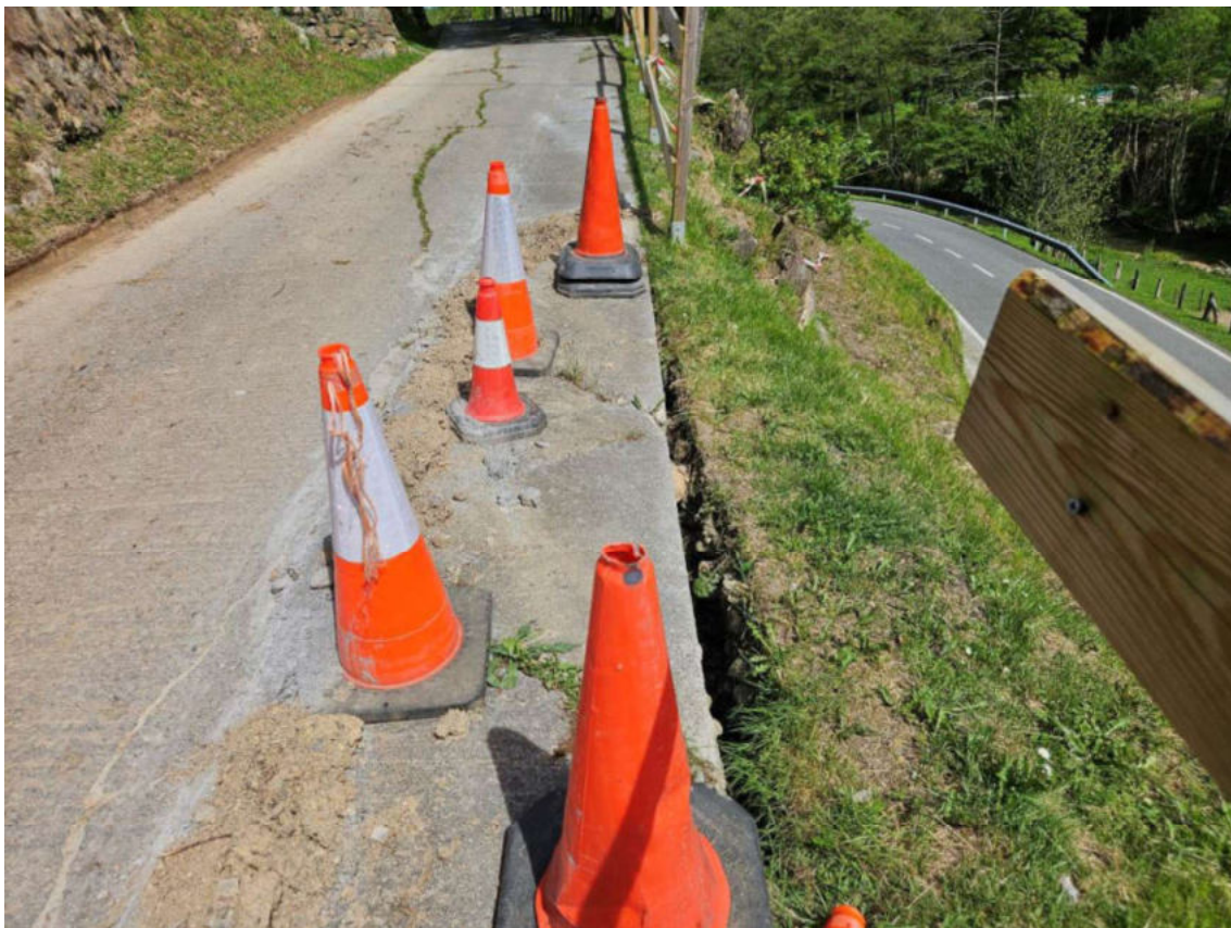
Fotografía1 daños en el camino de Urrutiña
