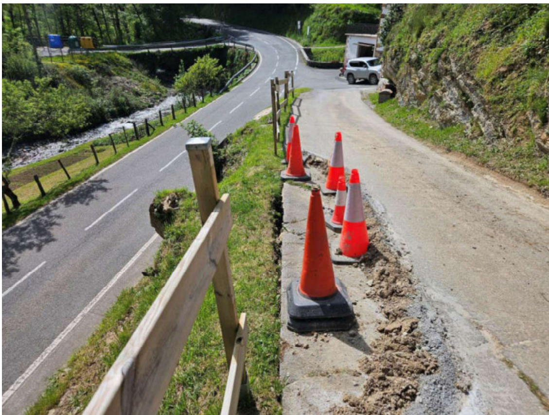
Fotografía2 daños en el camino de Urrutiña
