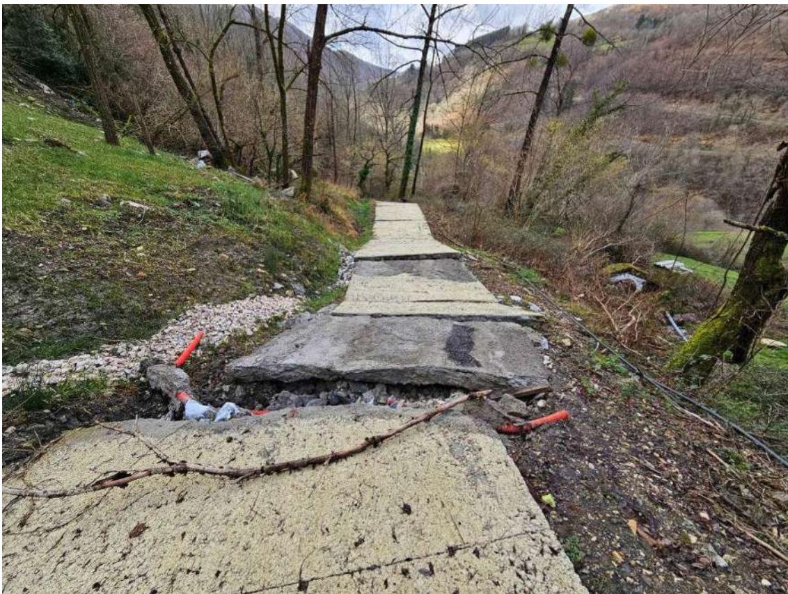
Fotografía1 daños en el camino a causa de un deslizamiento de la ladera por las fuertes precipitaciones
