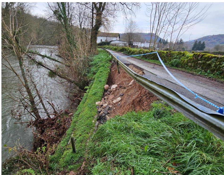
Fotografía1 del terraplén derrumbado en el camino
