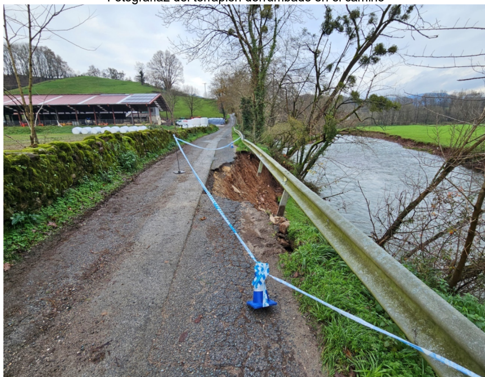
Fotografía3 del terraplén derrumbado en el camino
