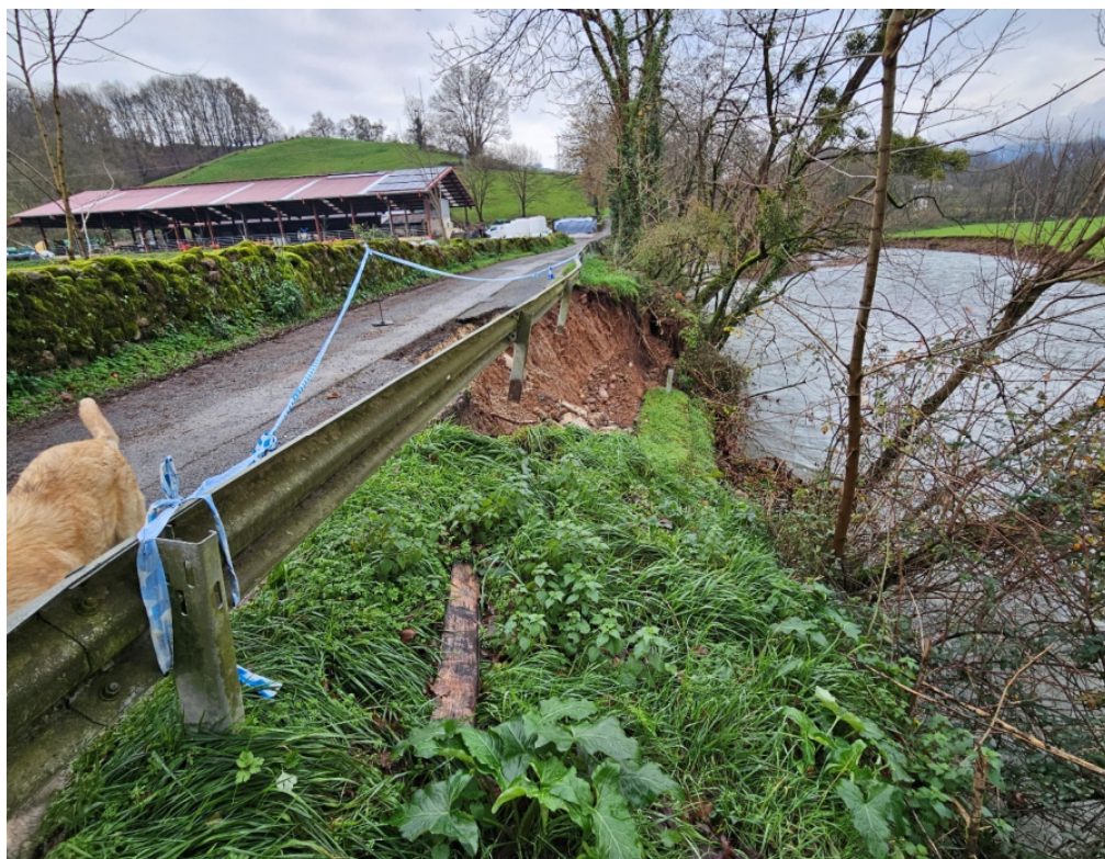
Fotografía2 del terraplén derrumbado en el camino
