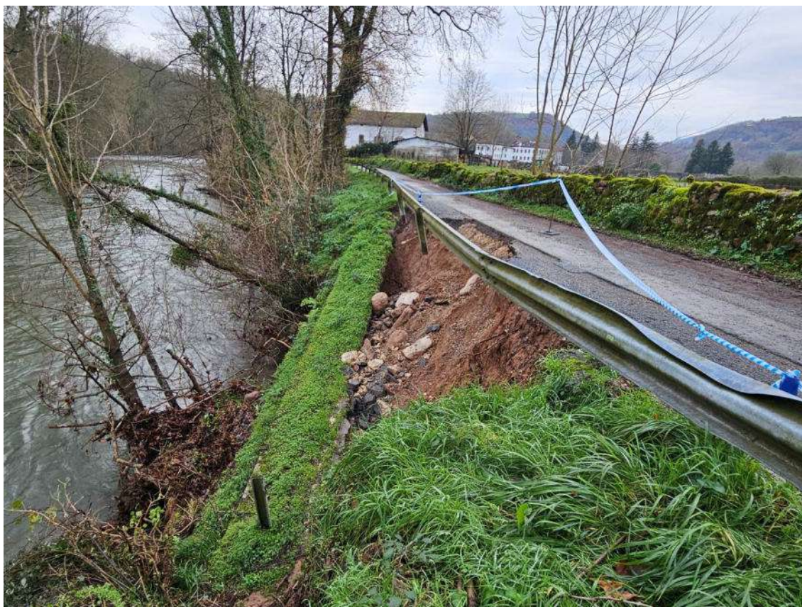
Fotografía1 del terraplén derrumbado en el camino
