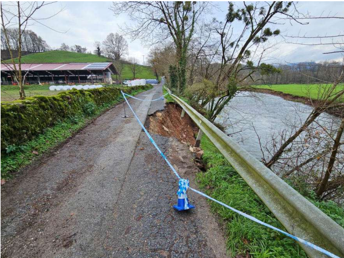
Fotografía3 del terraplén derrumbado en el camino
