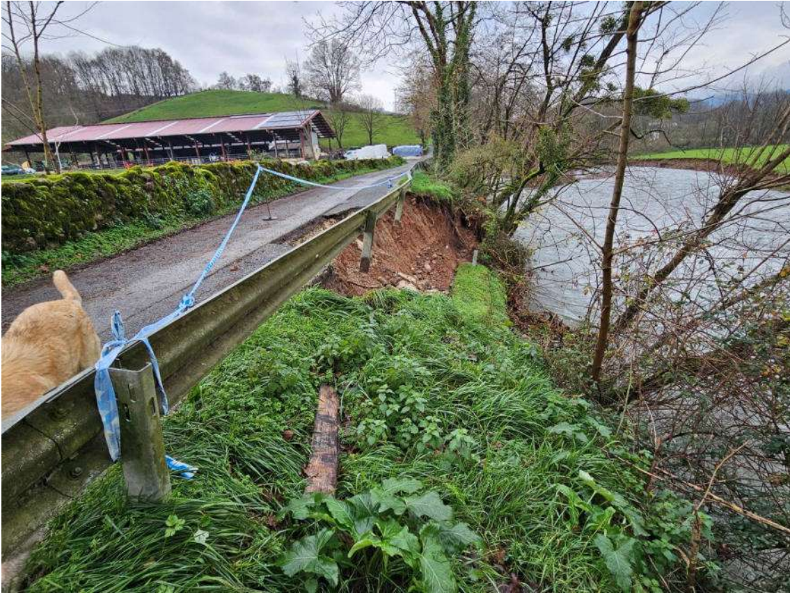
Fotografía2 del terraplén derrumbado en el camino
