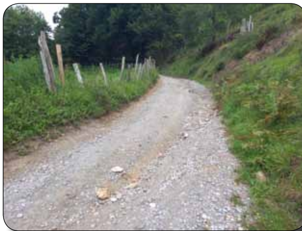
Daños producidos por el paso de agua descrito anteriormente
