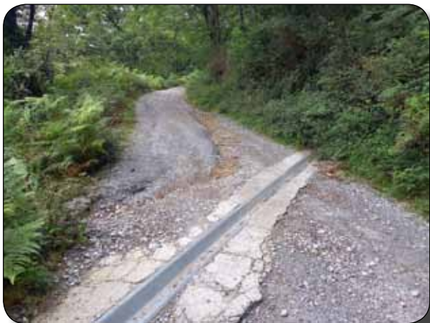
Escorrentía que no alcanza la cuneta y tampoco el drenaje transversal
