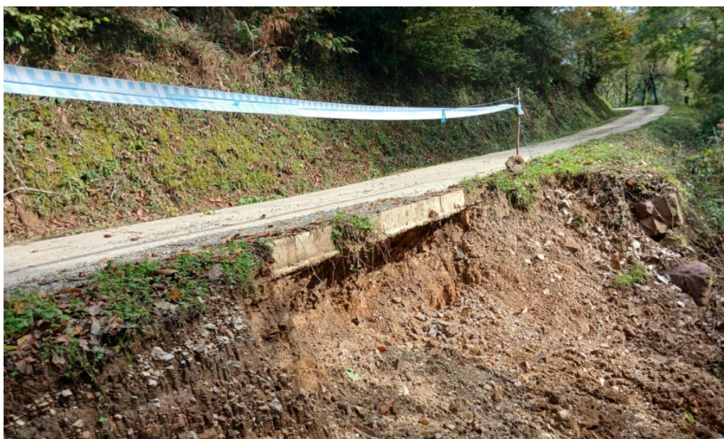
Fotografía1 del terraplén derrumbado en el camino
