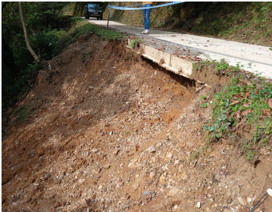
Fotografía2 del terraplén derrumbado en el camino
