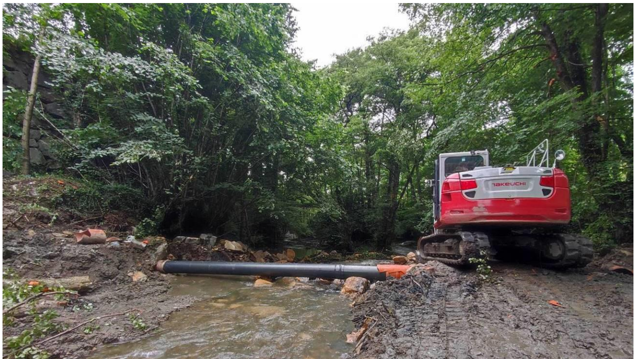
Figura 3: Solución temporal de extrema urgencia para evitar el vertido de aguas fecales al cauce.
