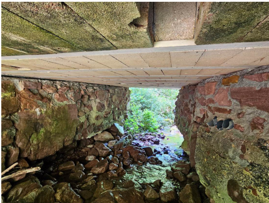
En la imagen se observa la erosión de los estribos del puente en el camino Otanartea
