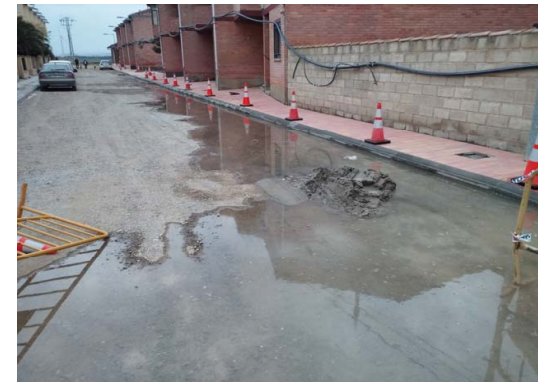
Vista general de encharcamiento de la calle Príncipe de Viana, en el momento en que los sumideros (conectados a acequia existente) han entrado en carga
