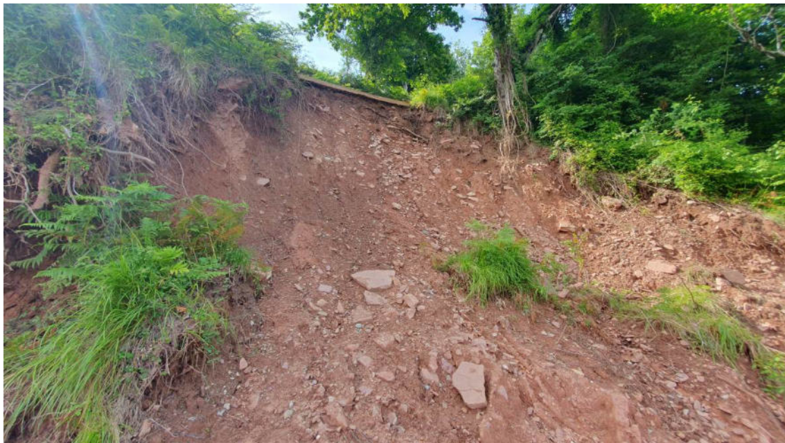
Fotografía2 daños en el camino a causa de las fuertes precipitaciones
