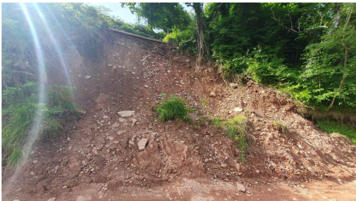
Fotografía3 daños en el camino a causa de las fuertes precipitaciones
