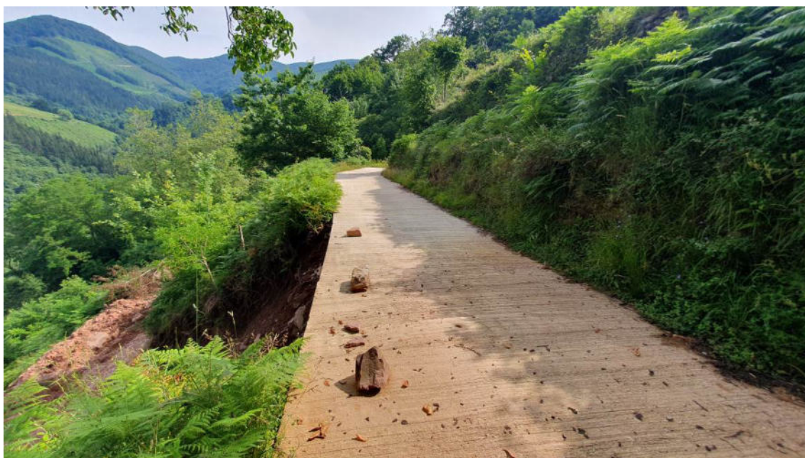
Fotografía1 daños en el camino a causa de las fuertes precipitaciones
