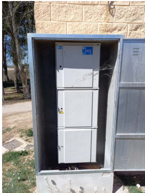
MODULO DE CONTADOR
