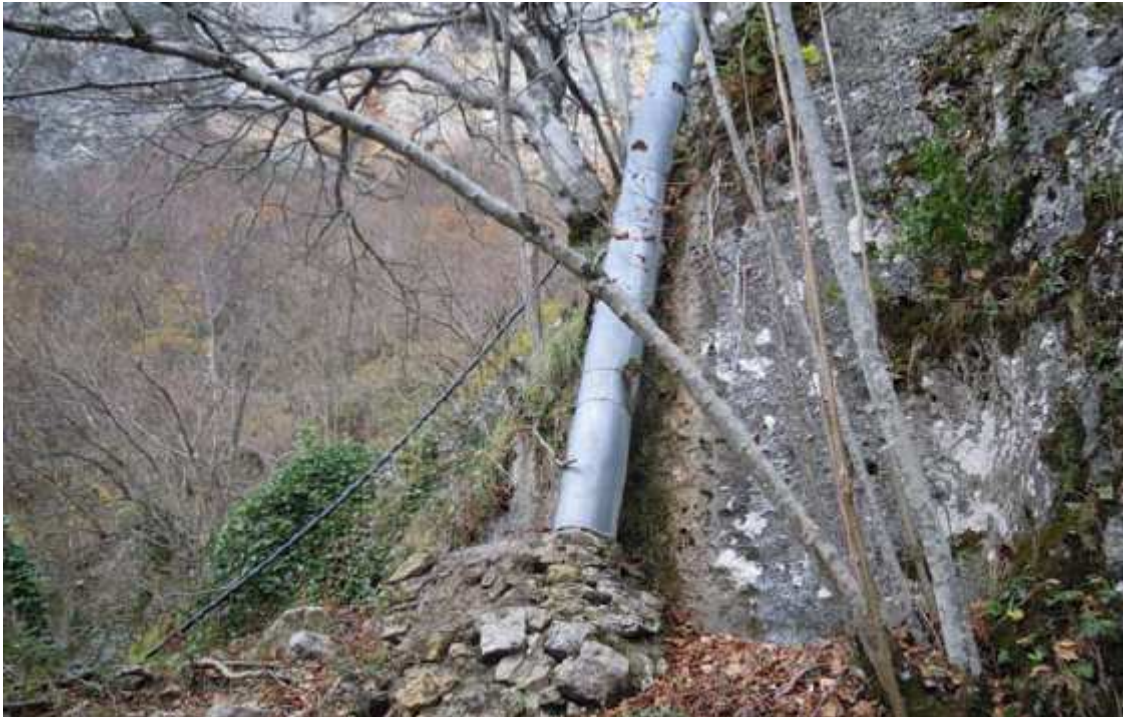
Punto de la tubería donde se introduce bajo tierra. En el área del proyecto hay también algunas hayas de pequeño porte y en las zonas más húmedas, las hiedras
