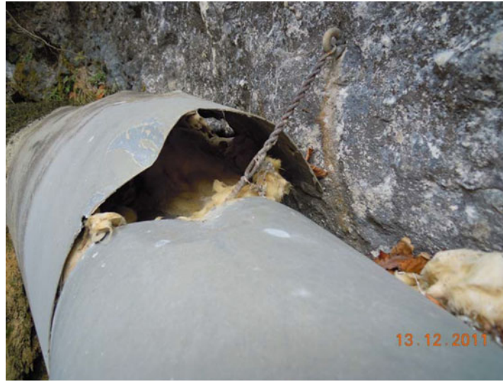
Figura 18: Chapas y aislamiento desprendiéndose
