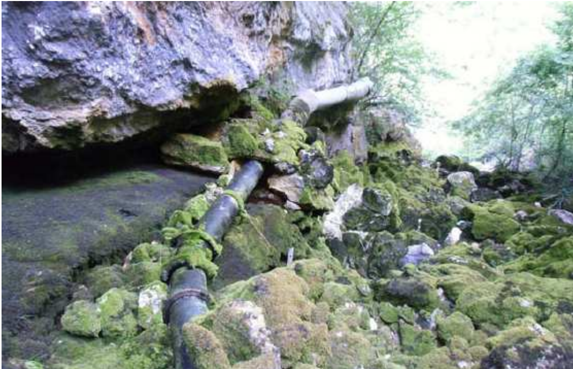
Tubería colgada en pared. En el área del proyecto predomina el roquedo, rocas recubiertas de musgo y rocas desprendidas del cantil
