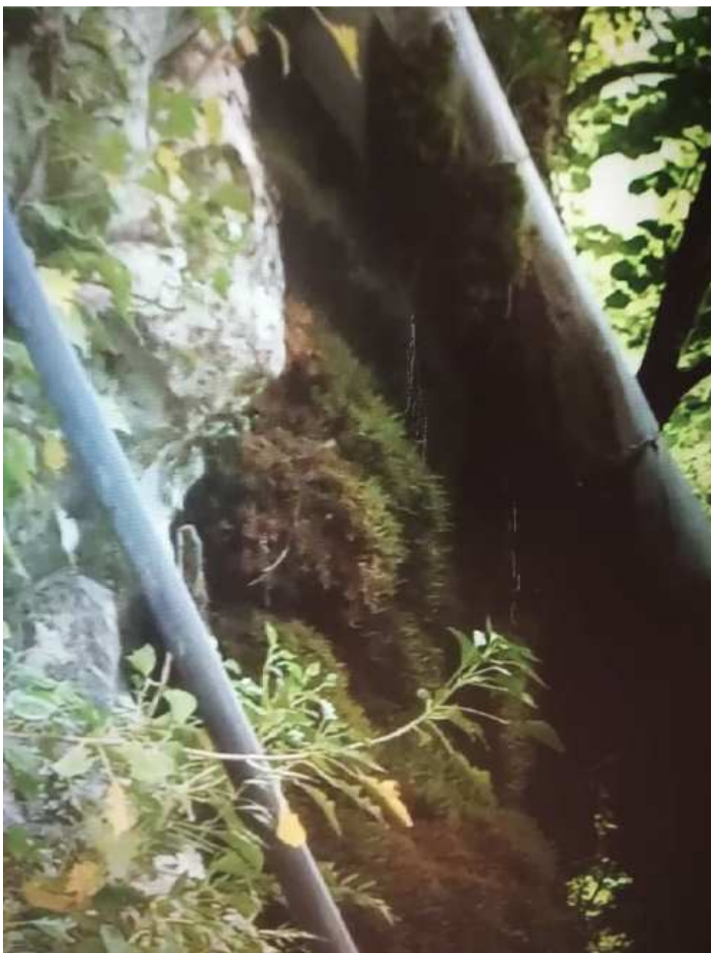
Fuga actual en tramo colgado
