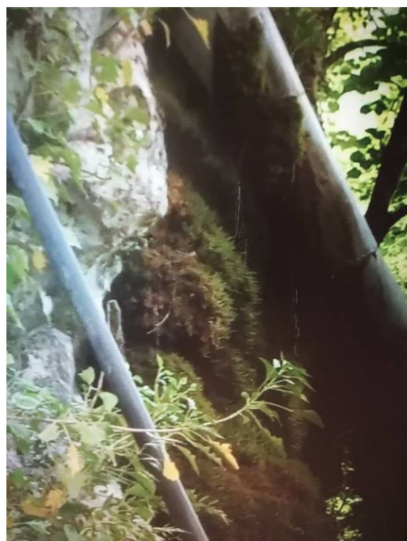
Figura 15: Fuga actual tramo colgado
