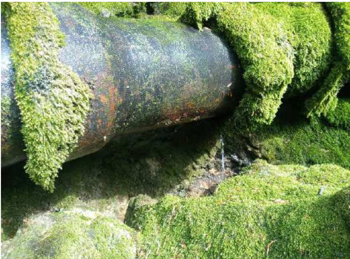
Detalle de fuga actual en el tramo aéreo, entre rocas recubiertas de musgo
