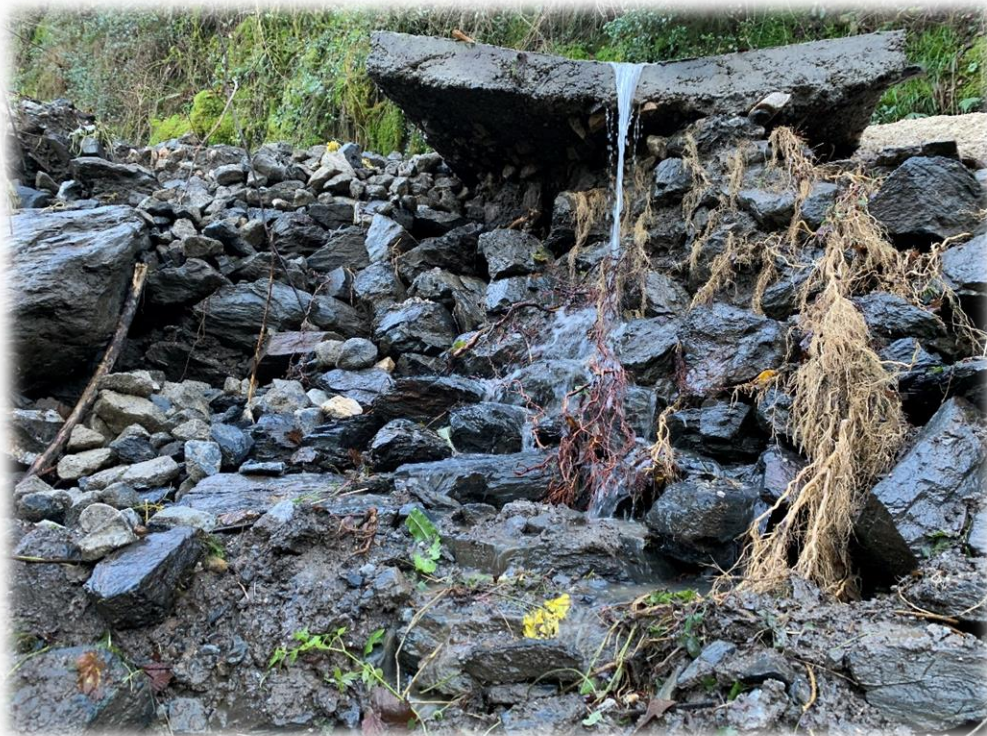
Fotografía 4: Vista salida drenaje en la boca norte del túnel de Larrakaitz, por donde vertió la inundación del túnel por el Bidasoa. Se ha perdido el muro de protección del talud
