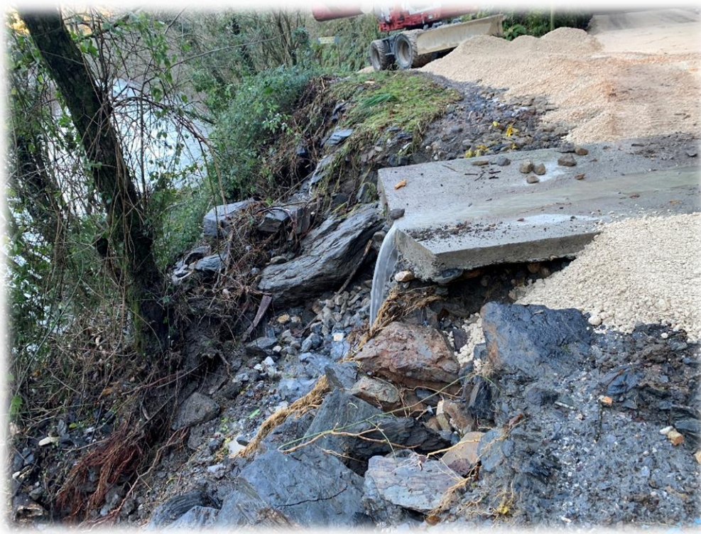
Fotografía 3: Vista salida drenaje en la boca norte del túnel de Larrakaitz, por donde vertió la inundación del túnel por el Bidasoa. Se ha perdido el muro de protección del talud
