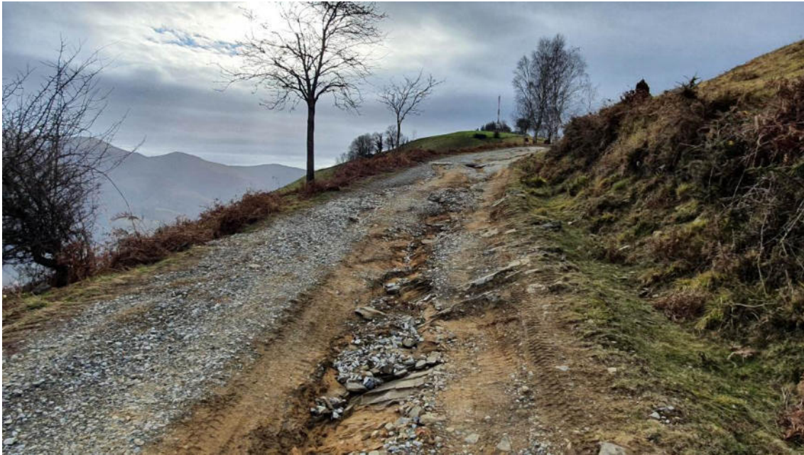
Otra fotografía del camino donde la riada ha erosionado la capa de rodadura
