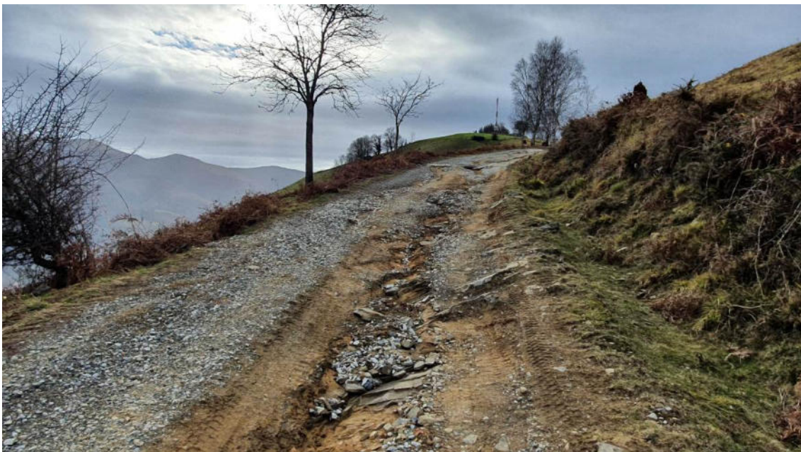
Camino Auntzaleku. Daños en la capa de rodadura del camino.
