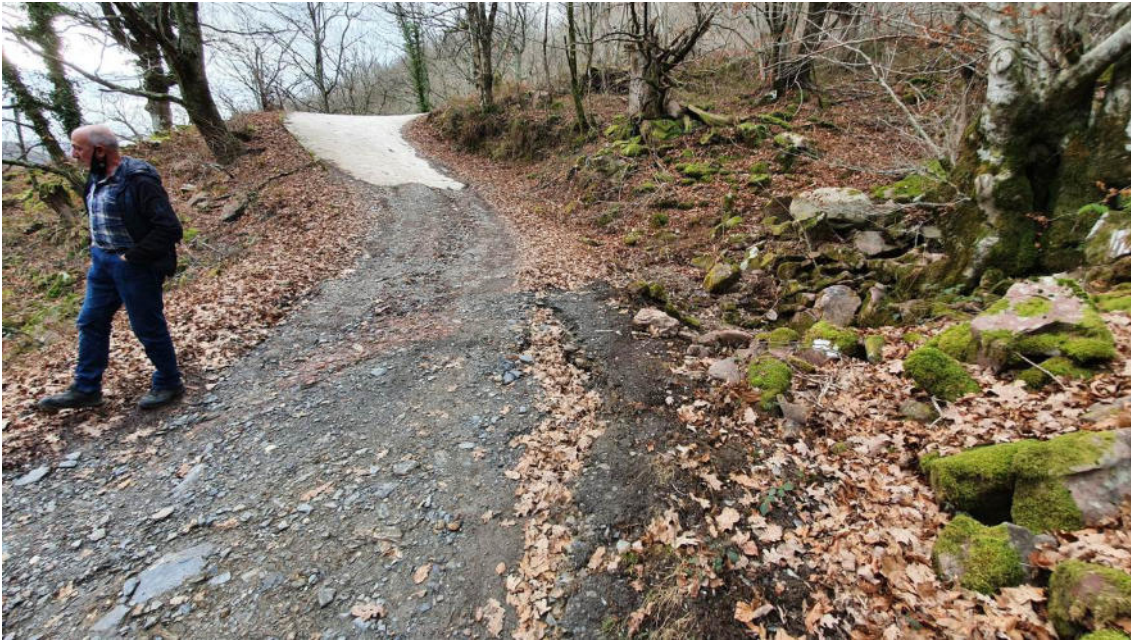
Camino Makilipurdi. Daños graves en el firme de zahorras existente
