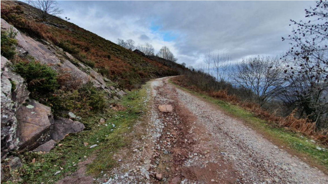
Camino donde la riada ha erosionado la capa de rodadura
