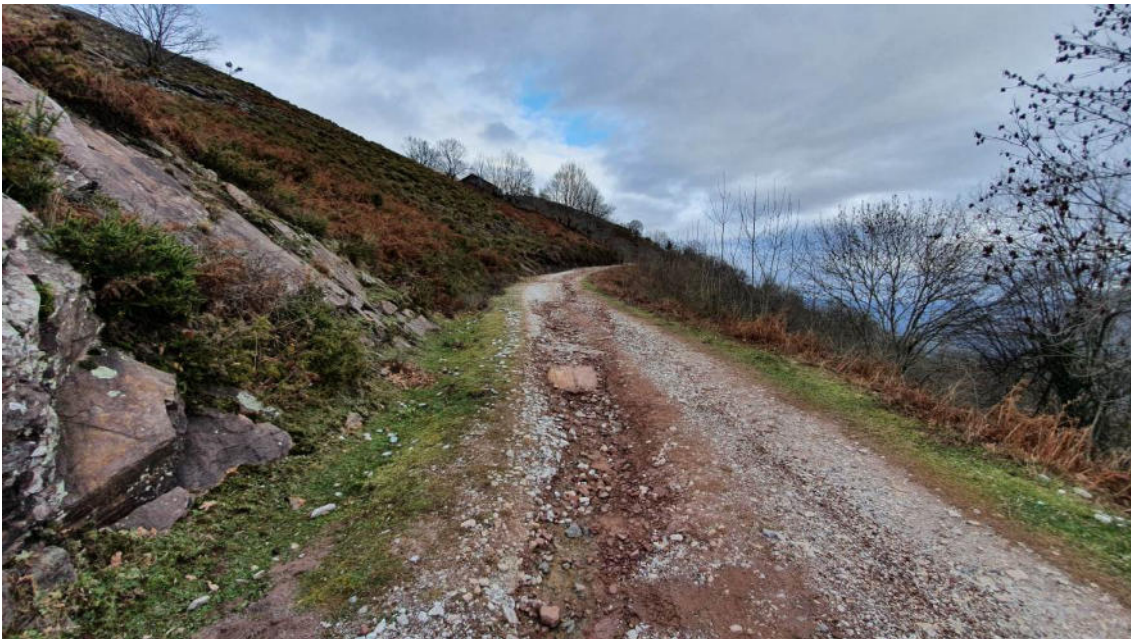
Camino Mendaur totalmente dañado y sin capa de rodadura
