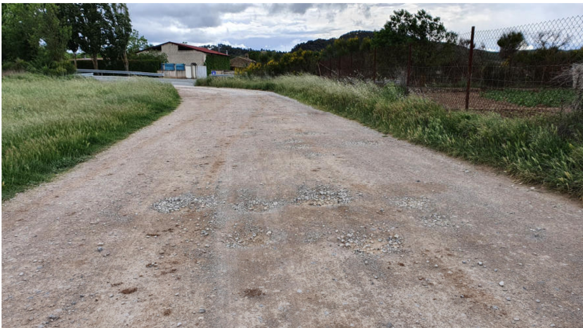
Fotografía donde se aprecia la existencia de baches y con áridos artificiales escasos. Zona llana
