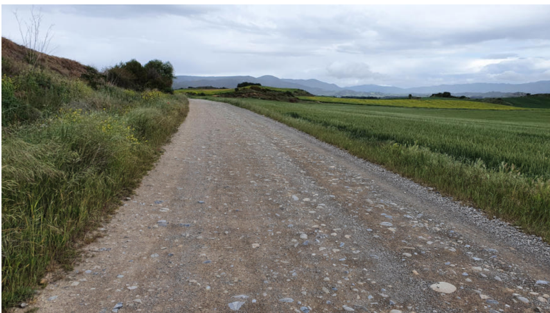
Fotografía donde se aprecia la existencia de baches y con áridos artificiales inexistentes. Zona llana
