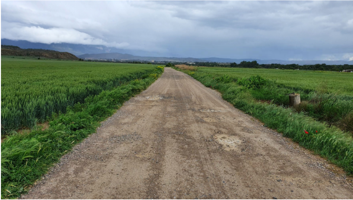
Otra fotografía con baches a reparar en firme sin apenas zahorras artificiales en camino Bornás. Zona llana
