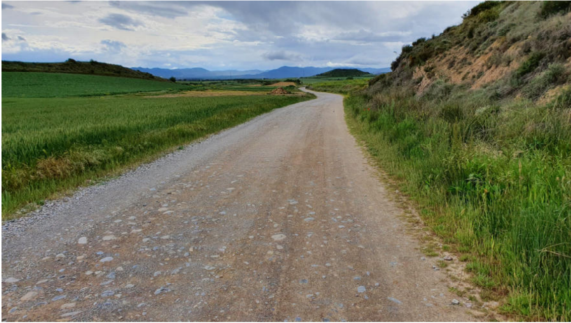
Otra fotografía donde se aprecia la existencia de baches y con áridos artificiales casi inexistentes. Zona llana
