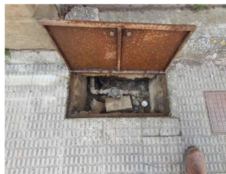
Contador en vía pública
