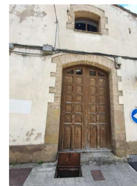
Ubicación contador (nave norte)
