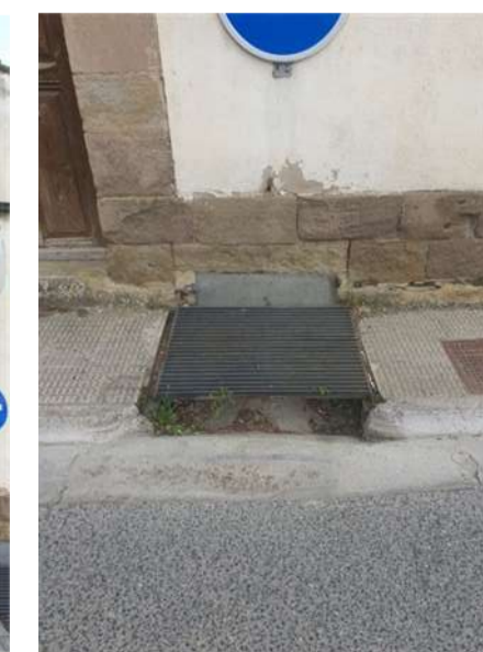
Evacuación pluviales bajo nave norte hacia el río
