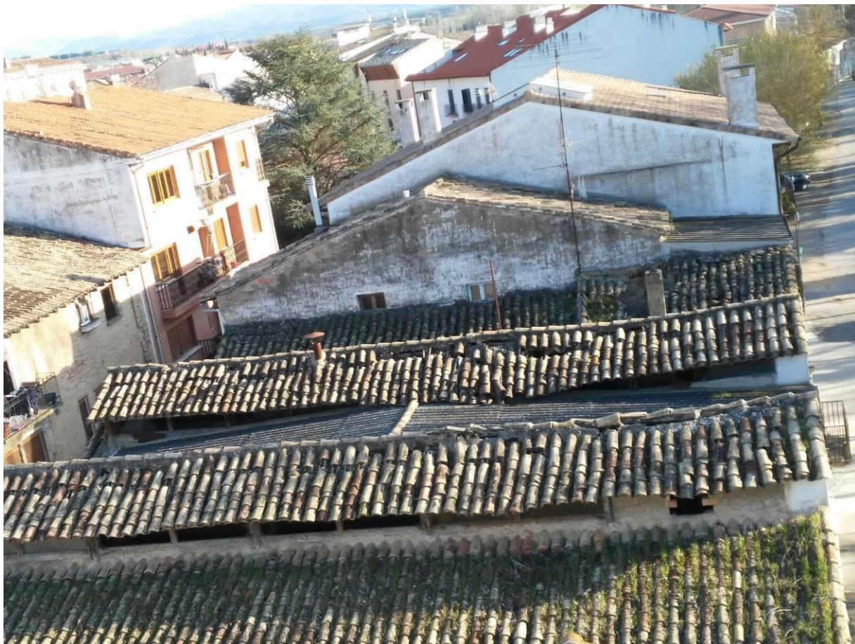
Estado de las cubiertas en 2017.
