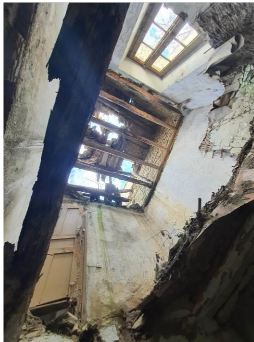
Vivienda: interior con forjados y cubierta colapsados
