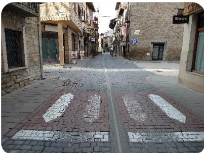
F4 Hundimiento asociado rodaduras y frenada
