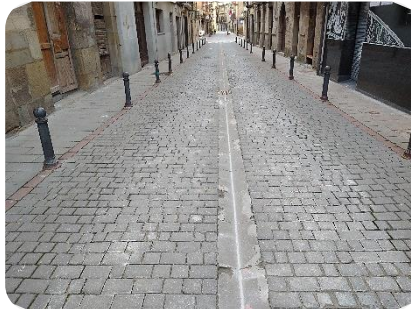
F2 Caz picado con numerosas reparaciones
