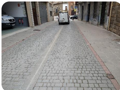
F11 Base de pilona desmontable sin uso
