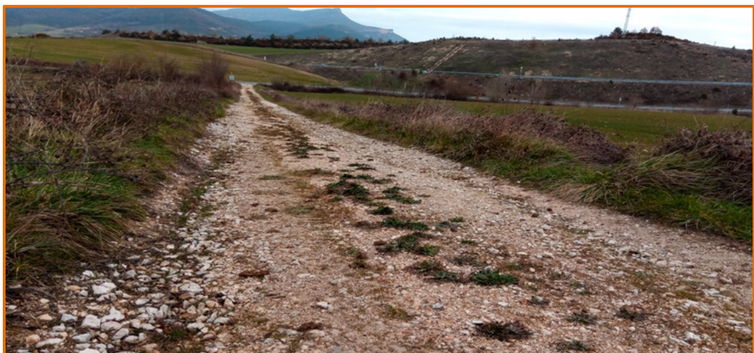
Ilustración 15: Tramo de Camino Celigueta-Muguetajarra con cuneta colmatada de material
