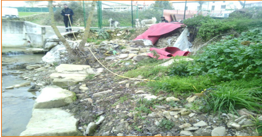
Ilustración 12: Tramo de Río Elorz en el entorno de Izco con escollera destruida tras avenida
