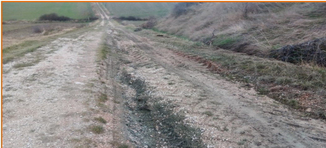
Ilustración 13: Detalle de tramo de ramal de Arqueta con daños en explanación por escorrentías
