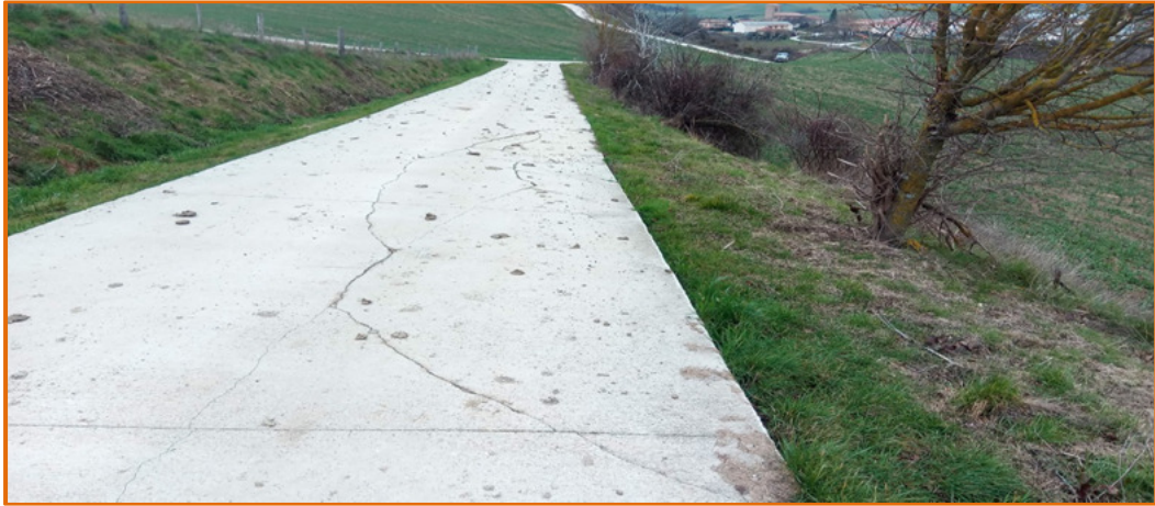
Ilustración 5: Detalle del estado actual de explanación minada y derrumbe de paños de hormigón
