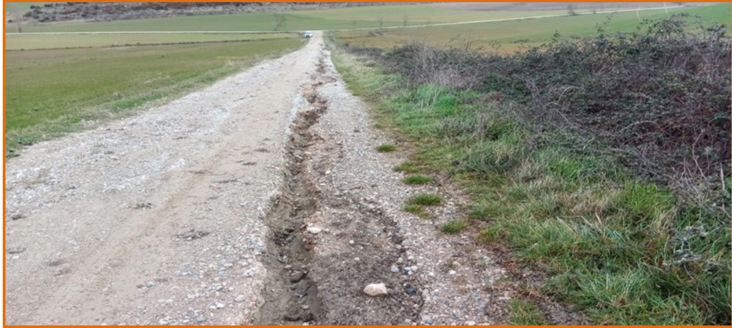
Ilustración 14: Tramo de Camino Celigueta-Muguetajarra con cuneta colmatada de material
