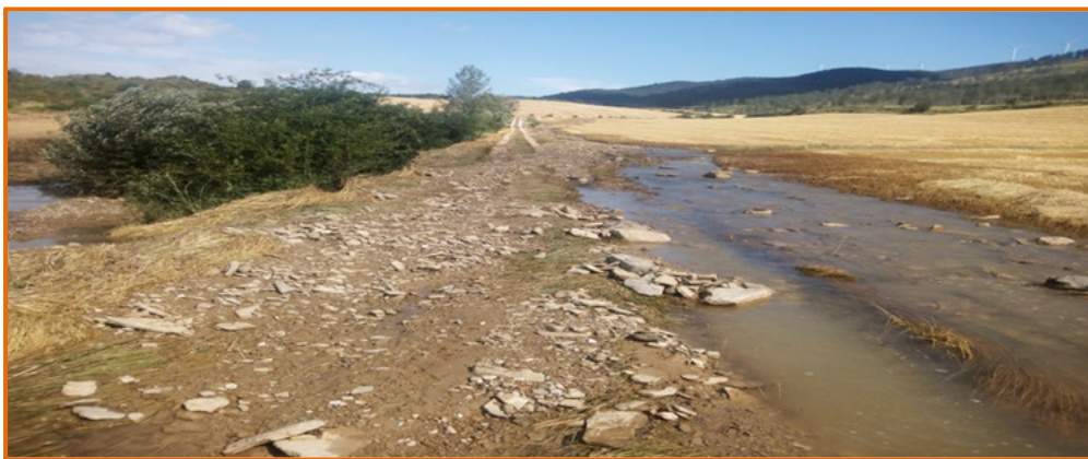
Ilustración 2: Detalle del tramo de vial con firme de zahorras arrastrado
