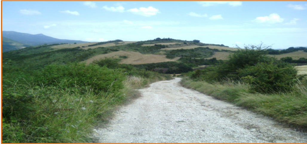
Ilustración 1: Detalle del estado actual del vial de Masain
