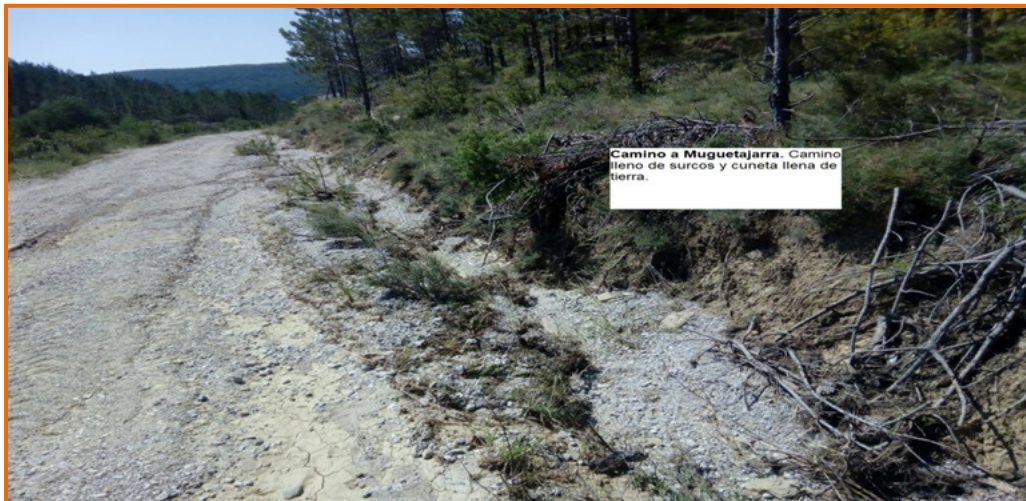
Ilustración 10: Tramo de Camino Celigueta-Muguetajarra con cuneta colmatada de material
