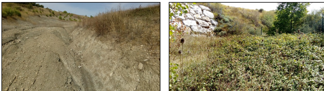
Figura 3. A la izquierda cuneta realizada en roca parcialmente colmatada por sedimentos, y a la derecha zona de la balsa de lixiviados invadida por la vegetación y colmatada por sedimentos.
