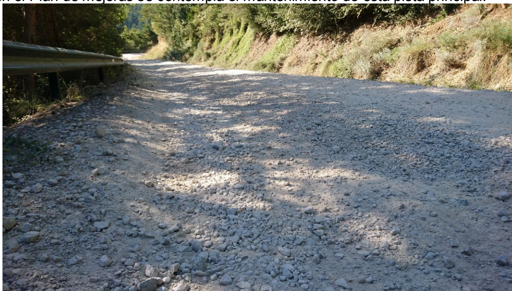
Fotografía del estado actual de la capa de rodadura del Camino de la Plana
