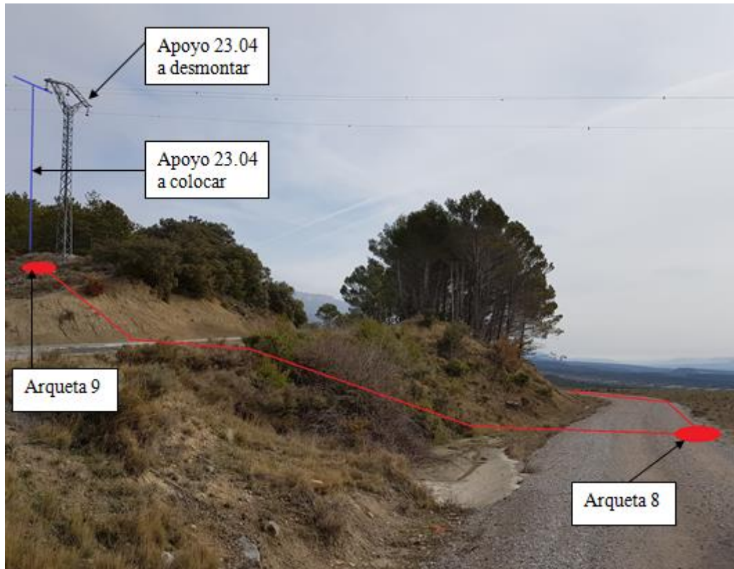
Final del tramo 1 en la que se ven las arquetas 8 y 9 y el apoyo nº 23.04
