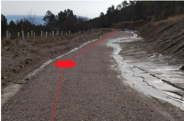
Arqueta 4 en la que se ubicará la reserva de fibra
