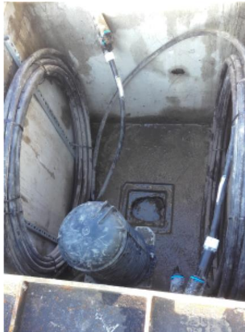
Detalle de arqueta de empalme
