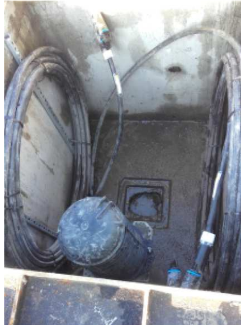
Detalle de arqueta de empalme
