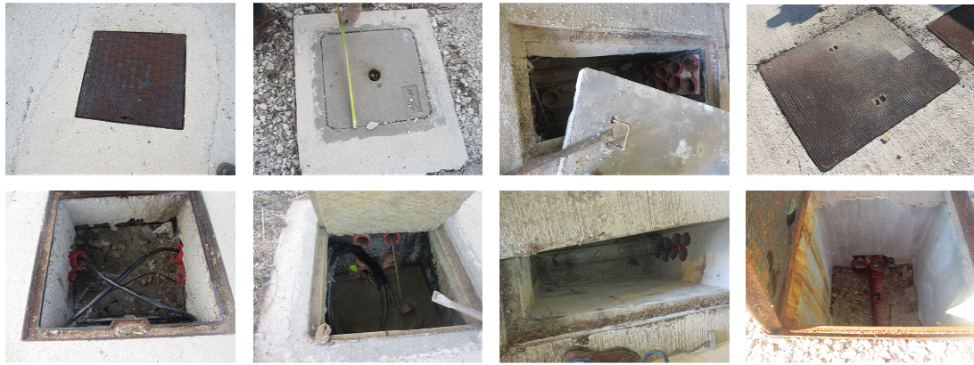
Figura 1: Arquetas por tramos: Monreal - Izco, Izco - Lumbier, Interior de túnel y Lumbier - Yesa
