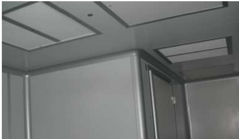
Ilustración 3: Panel vertical, con escocia de aluminio. Techo en panel con filtro terminal
